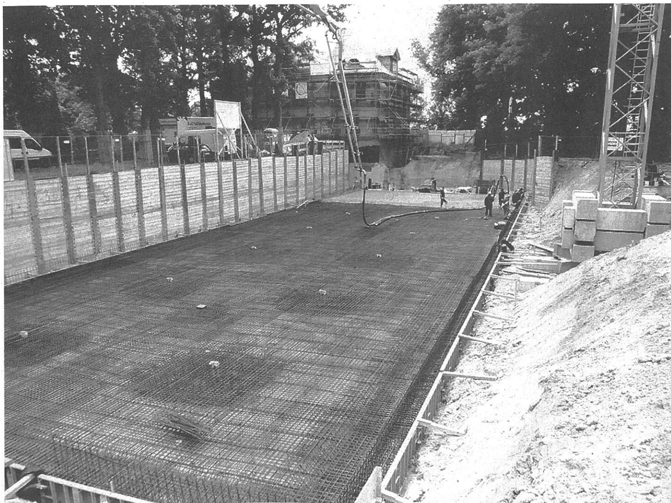
Das Abdichtungssystem SynkoFlex wurde bei diesem Projekt in Hamburg zur Abdichtung der verschiedenen Arbeitsfugen verwendet.
